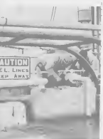
NA UN manifold special na No. 1 Finger Pier marineronan di Chemical Trader ta aser hose di manifold di e hapor na e linja di tetraethyl lead. E hose di neoprene di e bu
